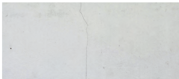
Vue d'une microfissure
