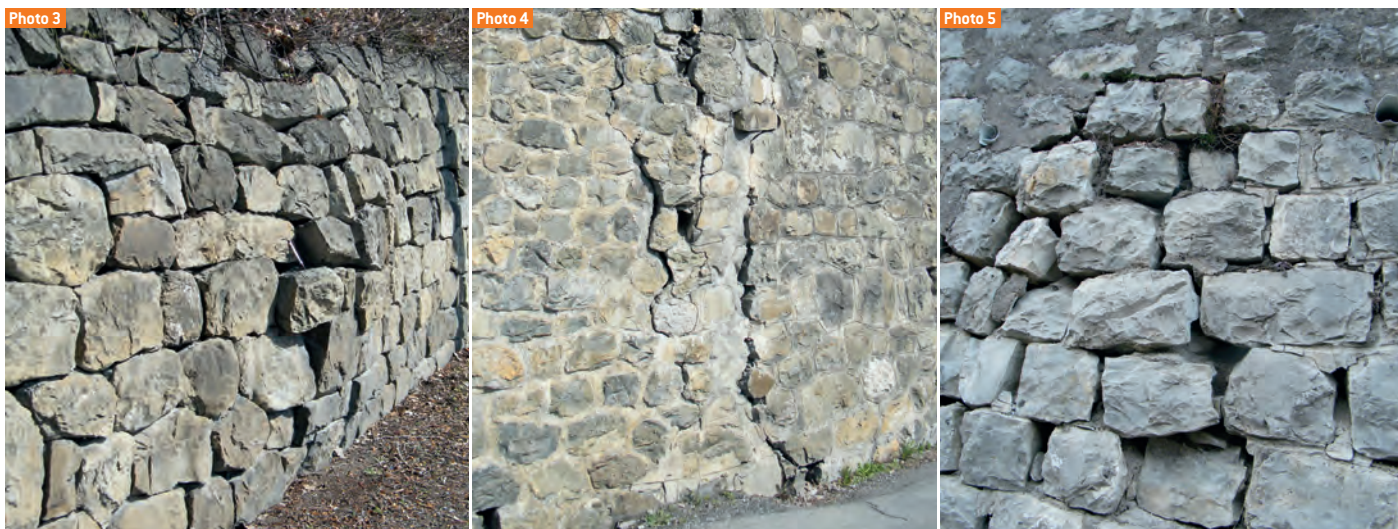
Exemples de manifestation des désordres. Photo 3 Bombement. Photo 4 Glissement. Photo 5 Désorganisation.
